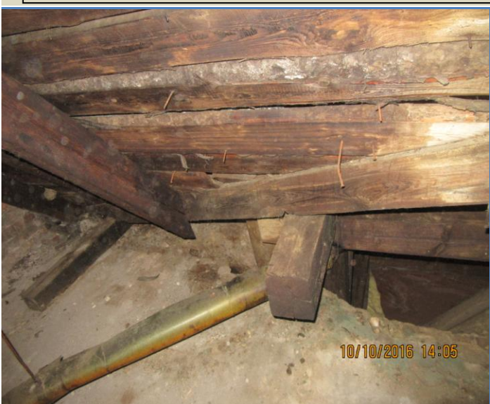
23.att. Bojātā jumta konstrukcijas satece.
