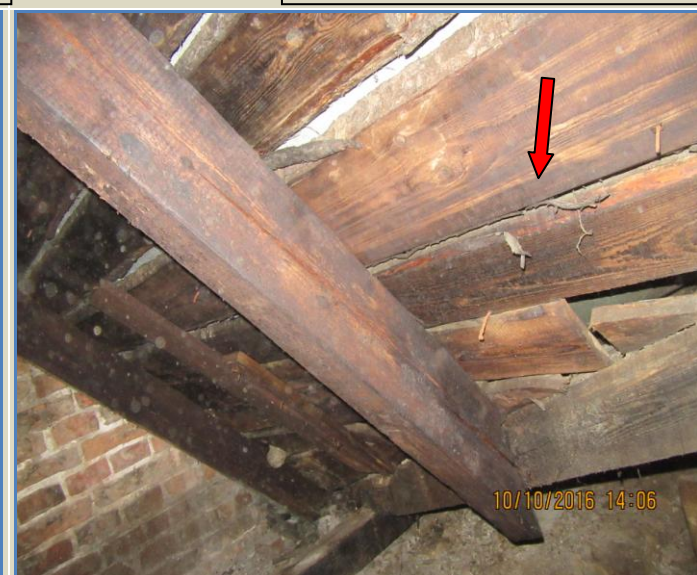
24.att. Bojātā jumta konstrukcijas satece.
