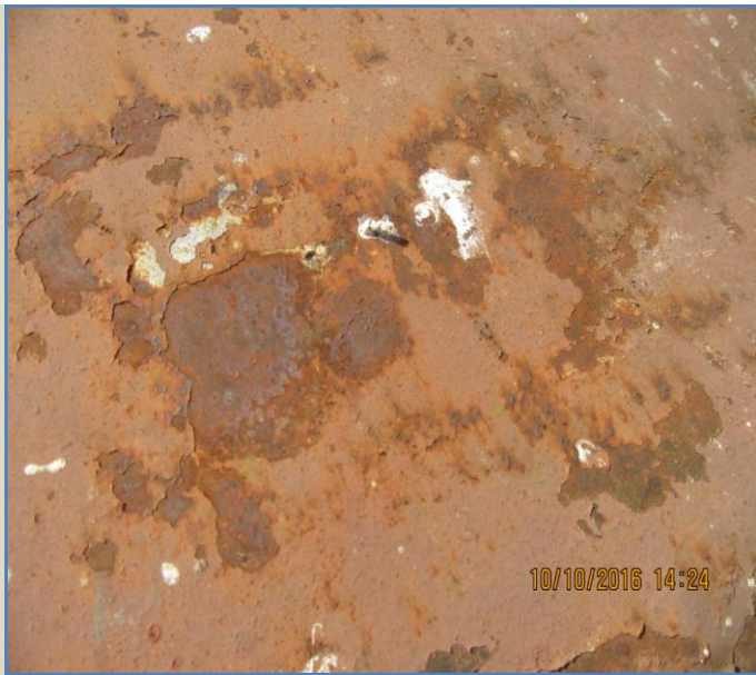
49.att. Jumta skārda seguma korozija.
