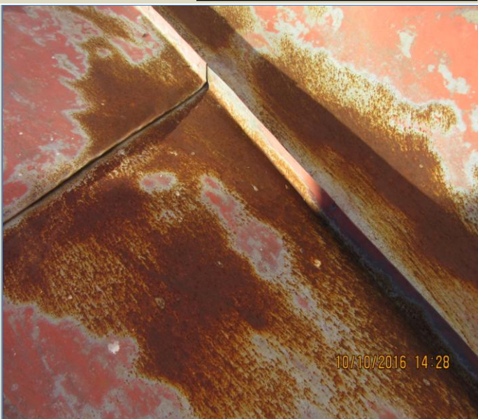
59.att.Korodējis skārda segums jumta satecē.
