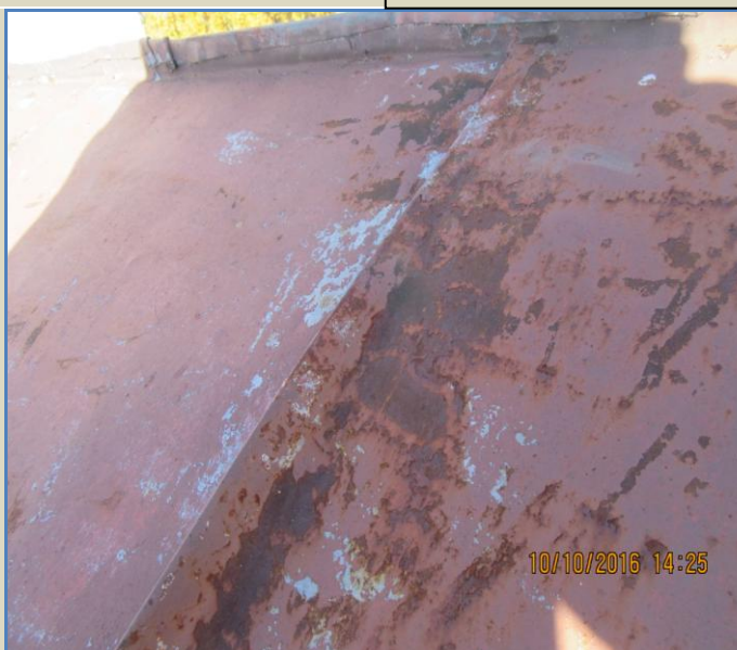
53.att. Jumta skārda korozija.
