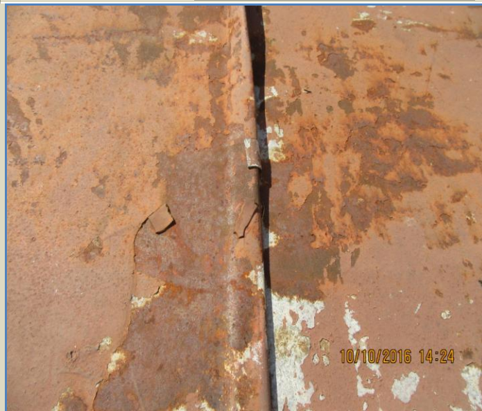
48.att.Jumta skārda seguma korozija.
