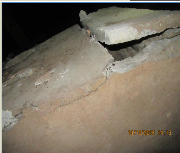
34.att. Bojāts ventilācijas kanāls ēkas bēniņos.
