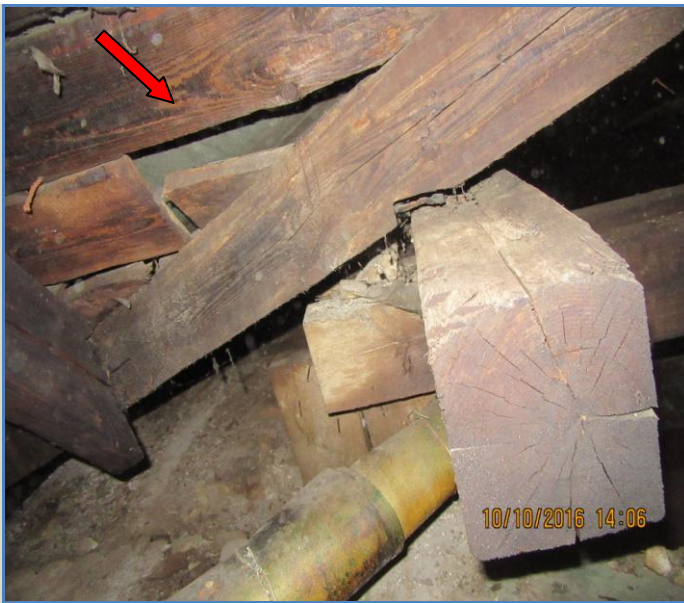
25.att. Bojātā jumta konstrukcijas satece.
