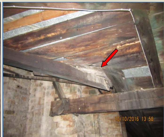
16.att.Bojāta jumta krēsla konstrukcija jumta iekšējā satecē.
