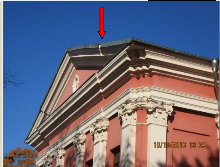
4.att. Bojāts jumta karnīzes skārda elements.
