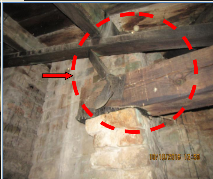
18.att.Neatbilstošs jumta nesošās konstrukcijas balsts.
