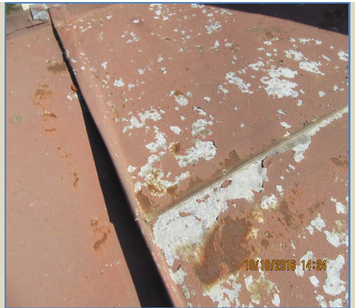
50.att. Jumta skārda korozija.
