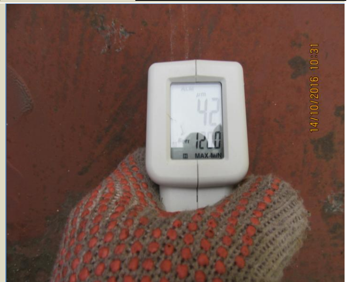
42.att. Krāsotā jumta melnā skārda krāsas pārklājuma biezuma mērījums.
