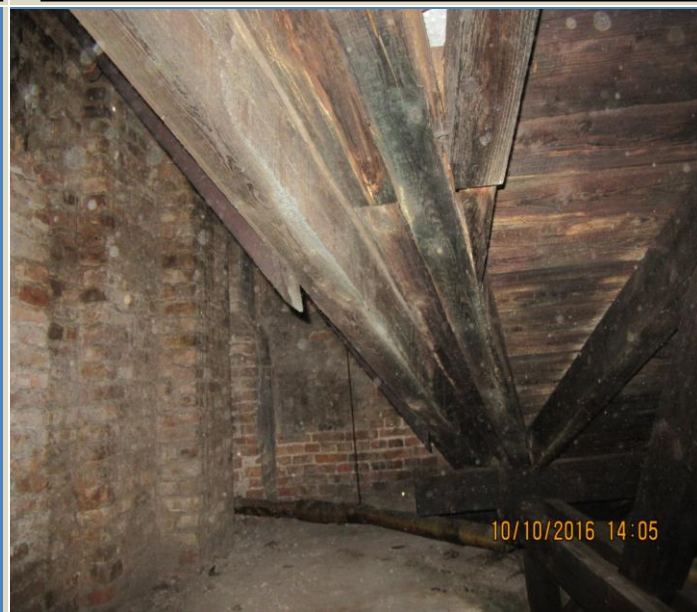
22.att.Bojātā jumta konstrukcijas satece.
