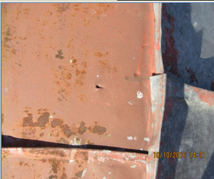
41.att. Jumta skārda seguma bojājumi.
