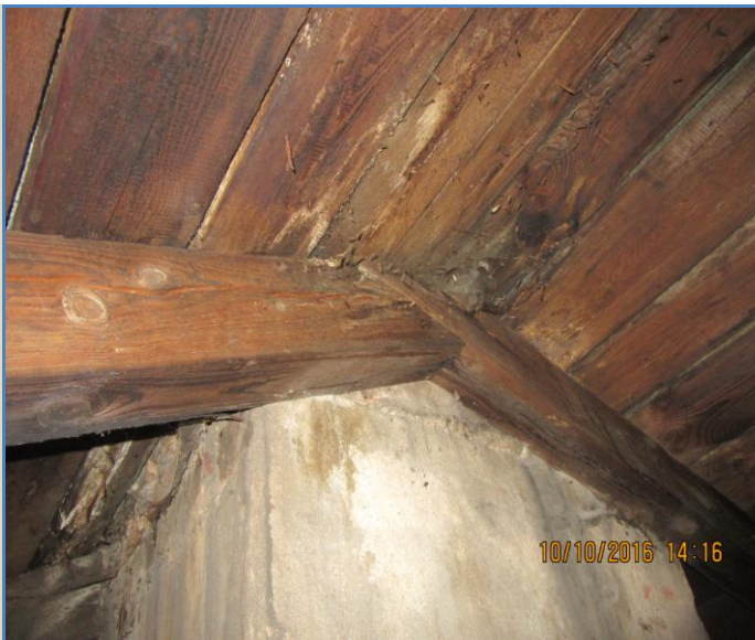
37.att. Bojāts jumta klājs pie dūmkanāla.
