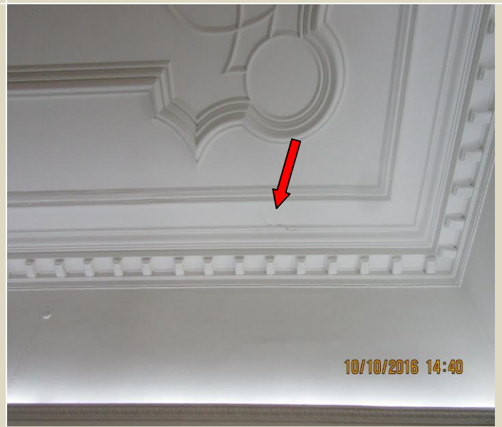
70.att. Lokāls bojājums zāles griestos.
