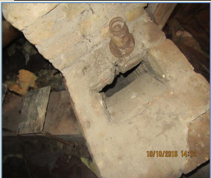
33.att. Vaļējs ventilācijas kanāls ēkas bēniņos.
