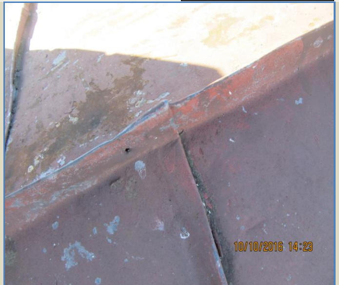
46.att.Jumta skārda seguma defekti.
