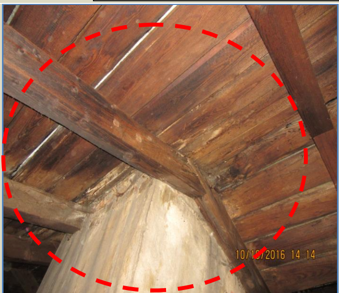
35.att. Bojāts jumta klājs pie dūmkanāla.
