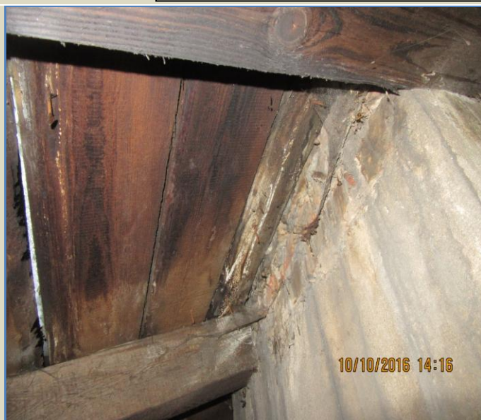
36.att. Bojāts jumta klājs pie dūmkanāla.
