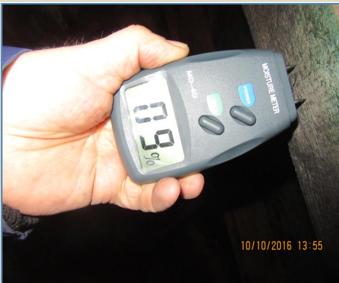
9.att. Jumta koka konstrukcijas virsmas mitruma mērījums.
