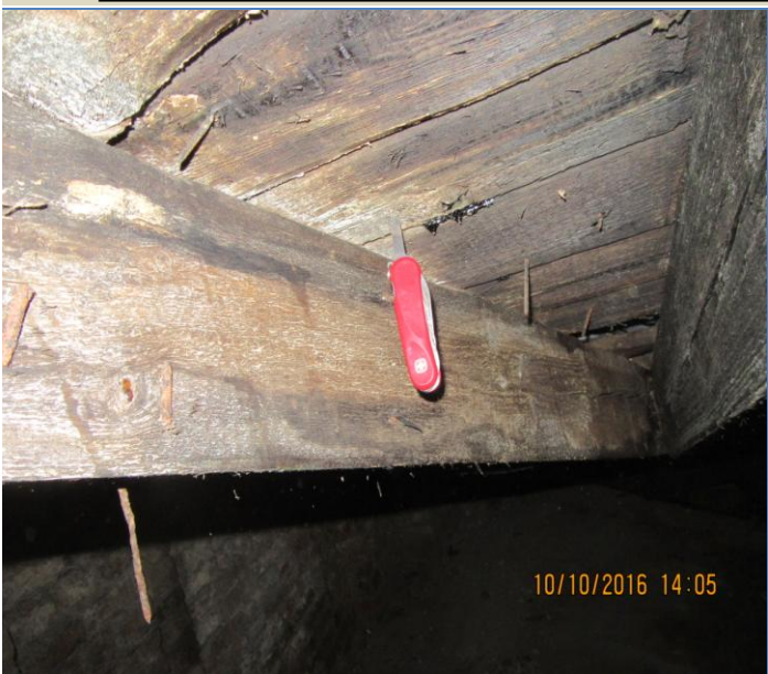
21.att.Bojātās sateces konstrukcijas koksnes cietības pārbaude.
