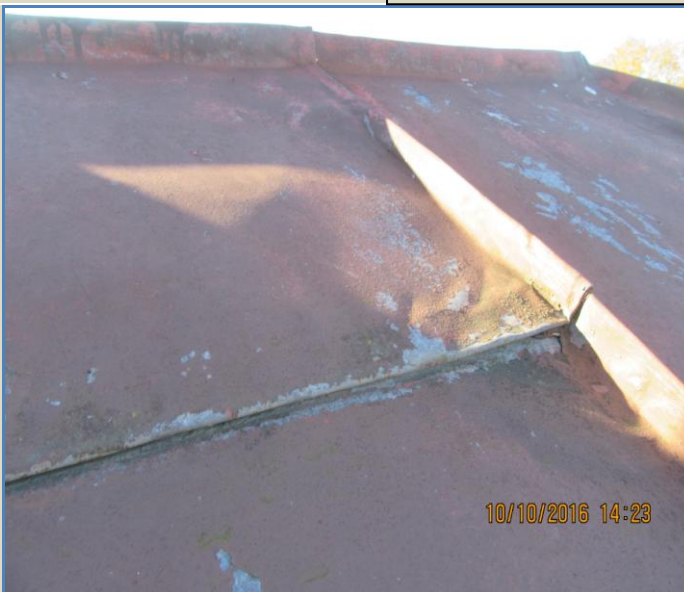
47.att.Jumta skārda seguma bojājumi.
