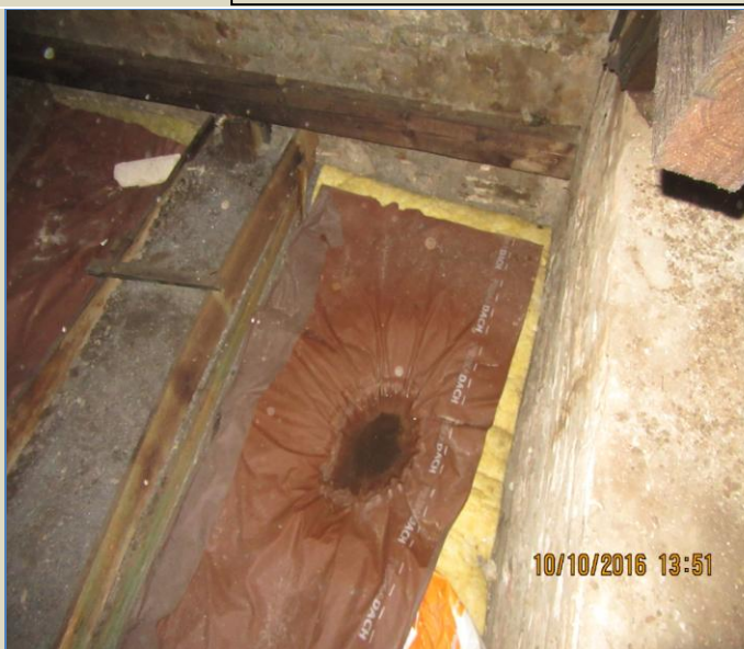
5.att. Lietus ūdens peļķes virs bēniņu siltumizolācijas.
