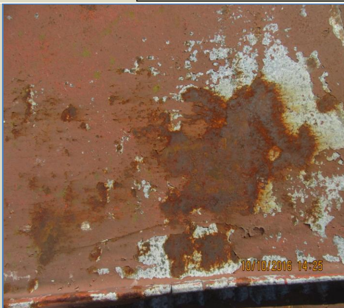
51.att. Jumta skārda korozija.
