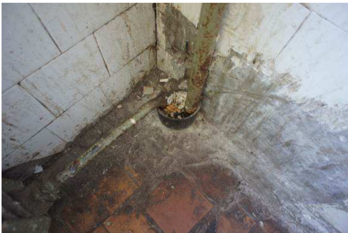
Foto attēls Nr. 26 Mitruma radītais bojājums grīdā
