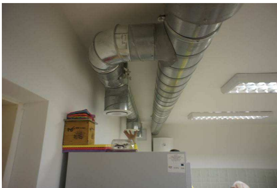
Foto attēls Nr. 8 Pagrabstāva ventilācijas sistēma
