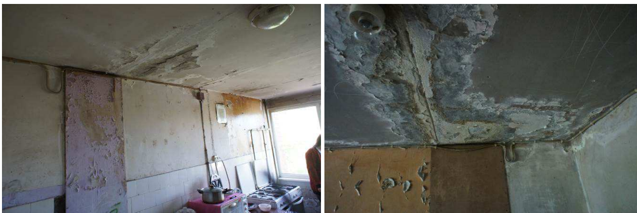
13. att. Mitruma radītie bojājumi pārsegumos
