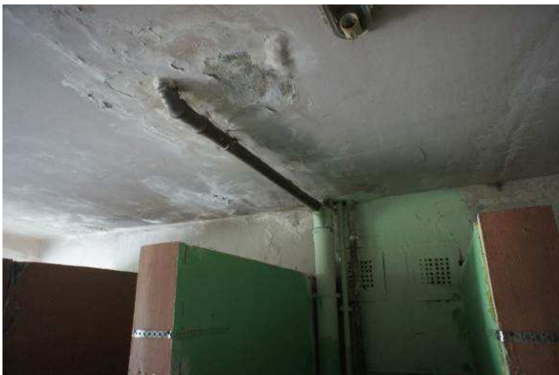
Foto attēls Nr. 22 Mitruma radītais bojājums griestos
