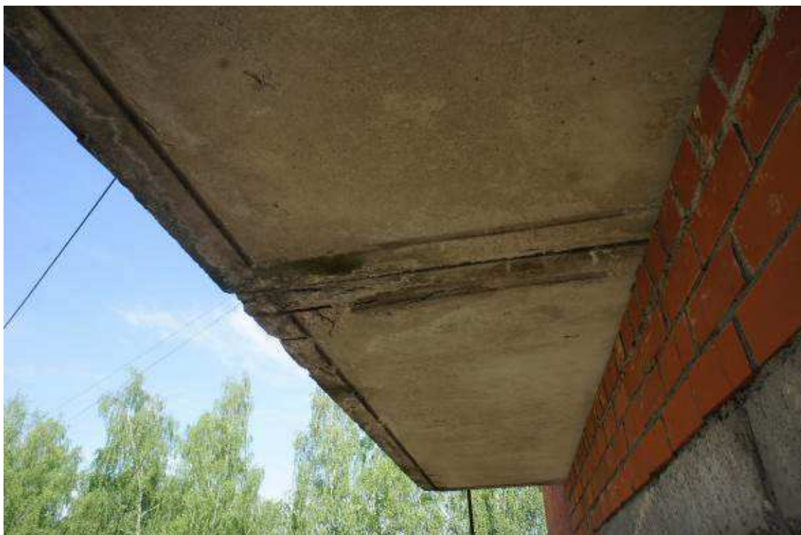
Foto attēls Nr.44 Jumta dzegā sakrājijs ūdens
