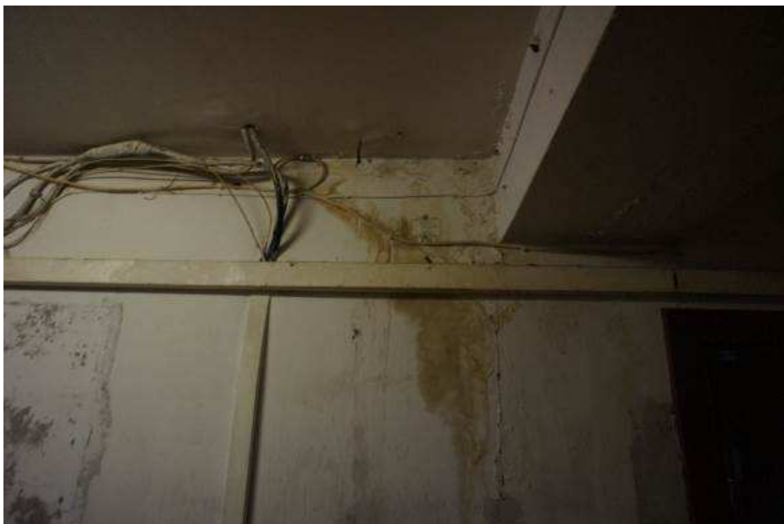
Foto attēls Nr. 17 Elektroinstalācija
