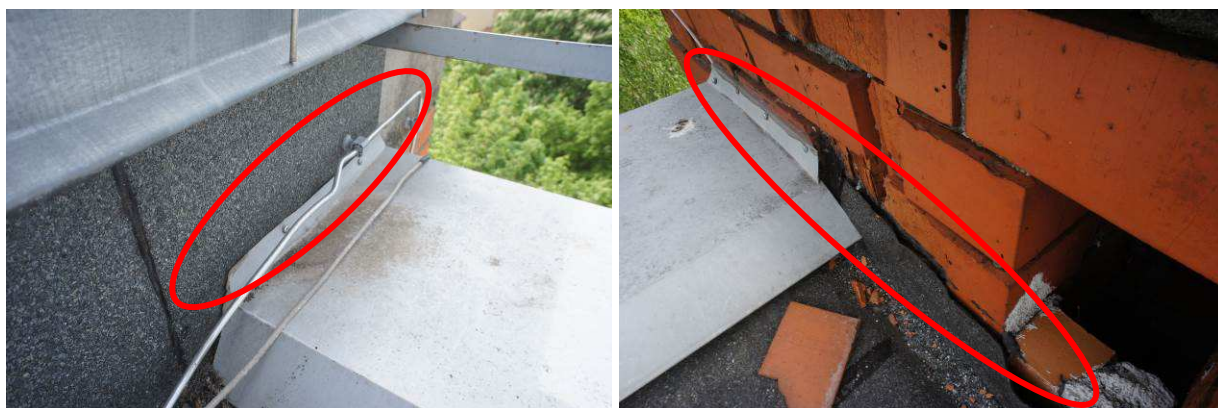
11. att. Parapētu nosedzošo skārdu un mūra savienojuma vietas
