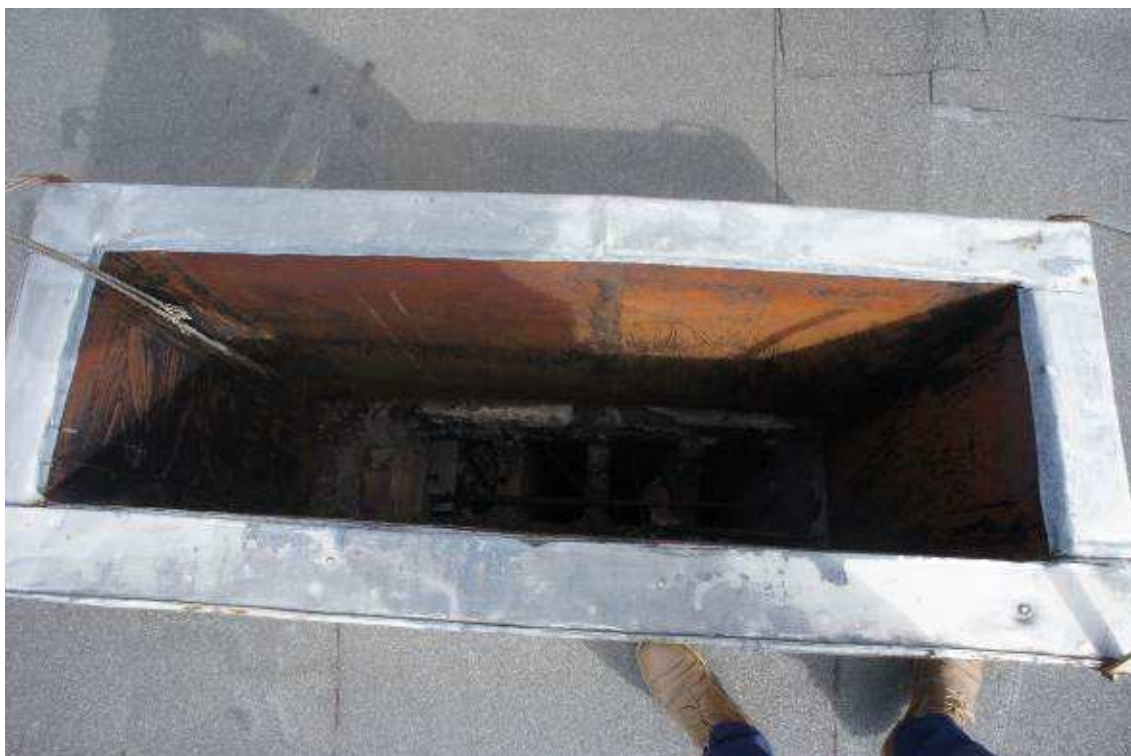
Foto attēls Nr. 39 Bojāts ventilācijas skurstenis
