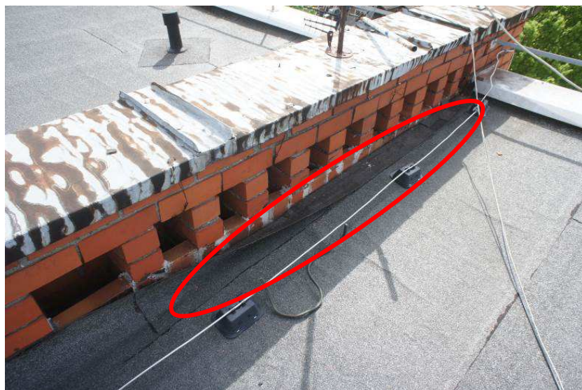
10. att. Ventilācijas šahtu un jumta seguma sadurvietas
