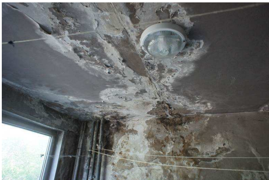
5. att. Mitruma rādītie bojājumi sienā un griestos
