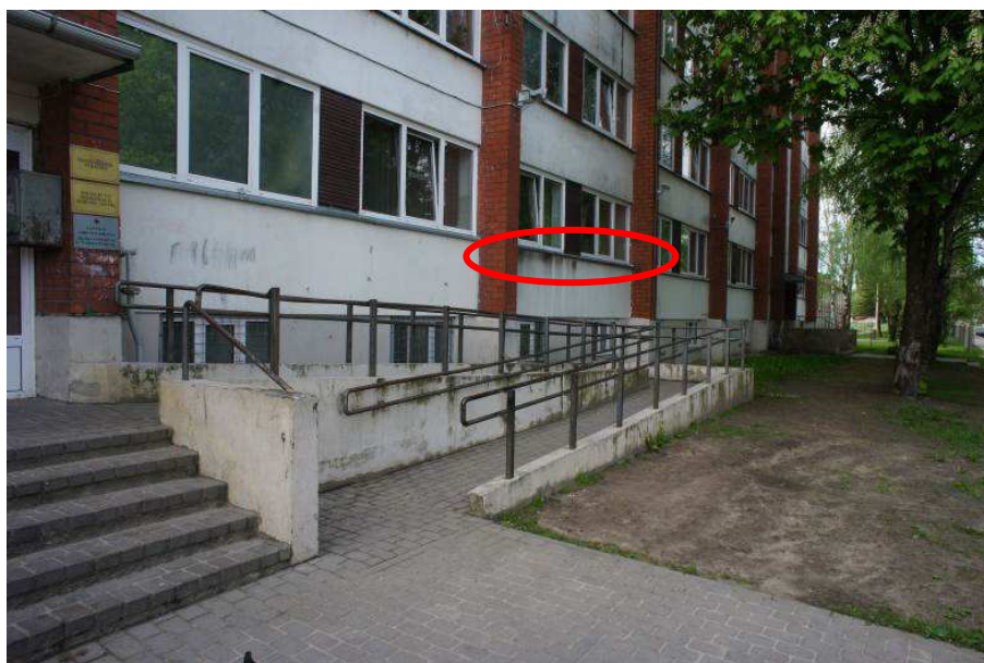
6. att. Mitruma rādītie bojājumi zem palodzes
