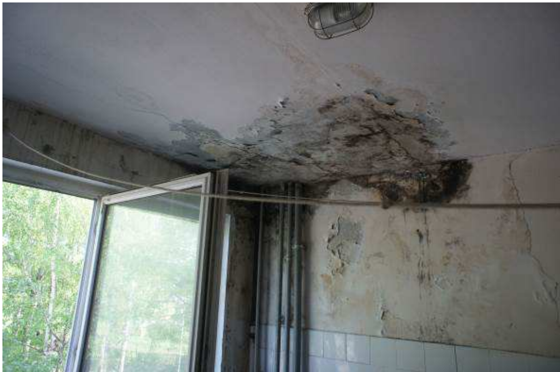
Foto attēls Nr. 24 Mitruma radītais bojājums griestos
