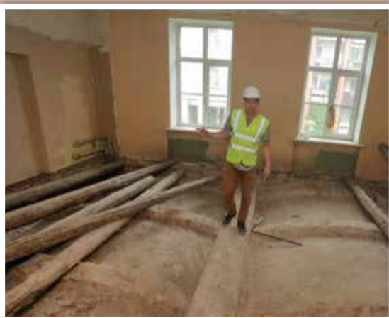
«Interesanta vēstures liecība ir grīdas vecākajā ēkas korpusā – tām ir arkveida ķieģeļu sijas, uz kurām liktas lāgas – resni balķi –, bet virs tiem klāta grīda. Savukārt vieta starp lāgām un ķieģeļu arkām bija aizbēta ar izdedžiem, kas izmantoti kā siltumizolācijas materiāls,» stāsta SIA «Torensberg» darbu vadītāja palīgs Edgars Ramanis.
