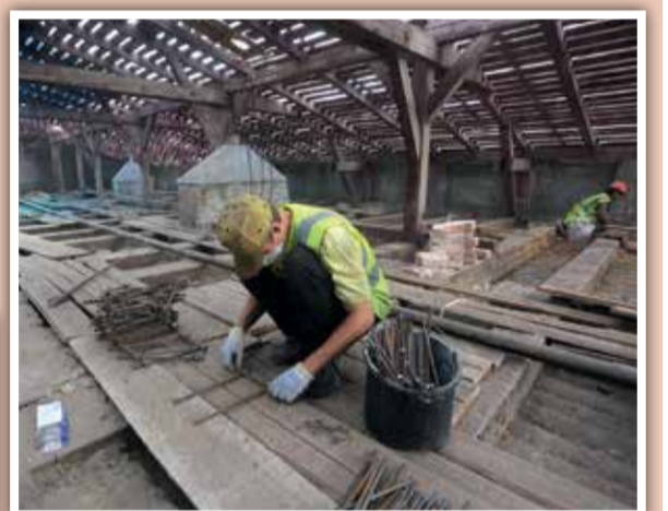
Pirms jauna jumta izbūves tiks pastiprinātas esošās koka sijas, jo daudzviet tās satrunējušas un sabojājušas. Kādā no telpām, noņemot rīpīša griestus, pat atklāties caurums, pa kuru var redzēt debesis. Bēniņos esošos skursteņus demontēs, jo tie lielākoties pildījuši ventilācijas funkcijas.
