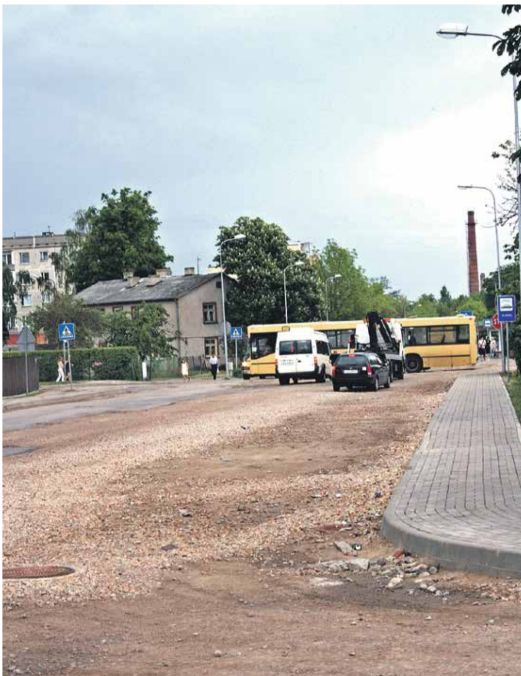
Satiksmes ielu 80 metru garumā no Celnieku līdz Traktoristu ielai atkal uzraks – šādu nepatīkamu pārsteigumu iedzīvotājiem sagādājis lietuviešu firma «KRS», kuras darbinieki nekvalitatīvi paveikuši cauruļvadu nomaiņu, un tagad caurules nāksies pārlīkt. Foto: JV
