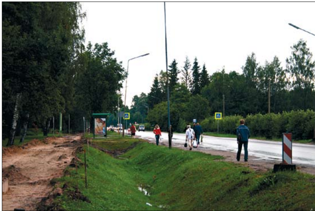
Rīgas ielas rekonstrukcijas darbu dēļ nojaukta ietve, un gājēji spiesti pārvietoties pa ielas braucamo daļu, apgrūtinot satiksmei. Bīstamas situācijas rodas, kad ir intensīva gājēju plūsma, piemēram, darba dienu rītos.
