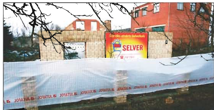
Dobeles šosejā trīs pusnojauktu privātmāju vietā gada laikā jāatop jaunam tirdzniecības centram «Selver», kas sava piedāvājuma un kvalitātes ziņā būs pa vidu starp jau mums pazīstamajiem «Rimi» un «Sky» lielveikaliem. Foto: Ivars Veiliņš
